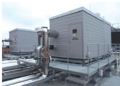
冷温水発生器
