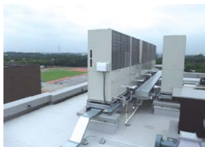
ガスヒートポンプエアコン
