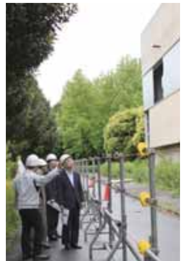
総合体育館 外部の破損
