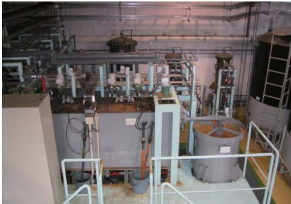
鉄粉法廃液処理設備
