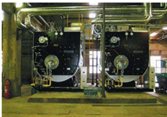
新ボイラ 2.69 Gcal/H × 3基 (ガス焚き) 3.88 Gcal/H × 2基 (ガス焚き)
