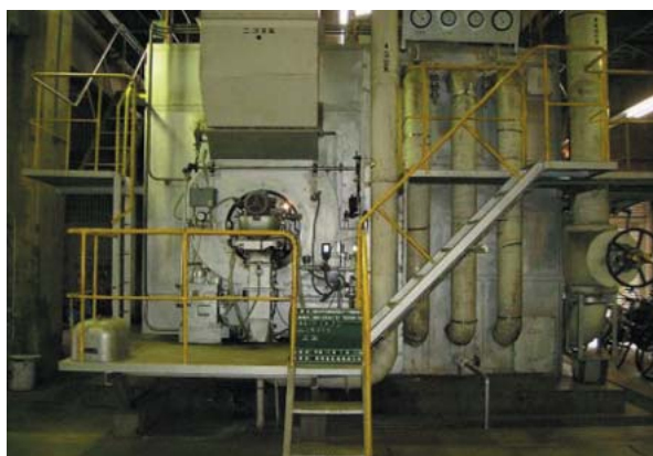
旧ボイラ 18 Gcal/H × 3基 (A重油焚き)
