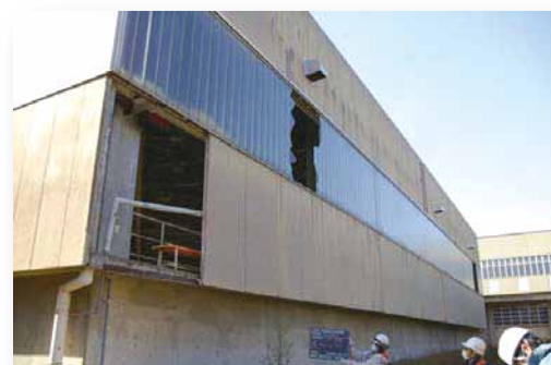
総合体育館の損壊
