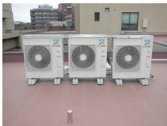
大学会館A棟に個別方式空調機の設置
