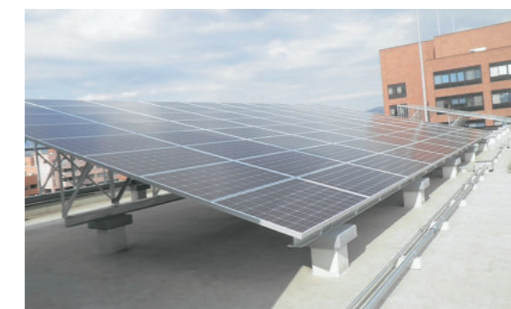
中央図書館屋上太陽光パネル
