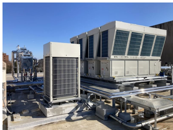
アイソトープ棟 (ヒートポンプチラー)
