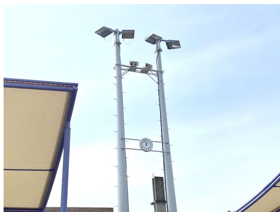
陸上競技場照明塔 (LED照明器具)
