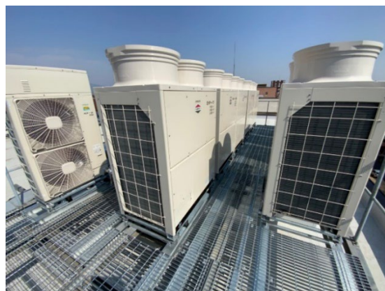
工学系学系E棟 (電気式空調機)
