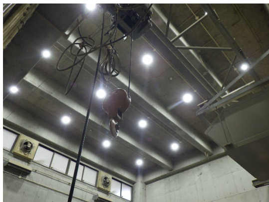
芸術学系工房棟 (LED照明器具)
