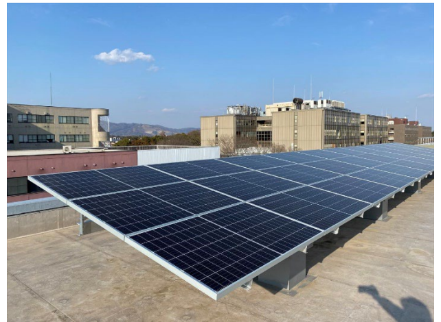
6 B棟屋上太陽光パネル
